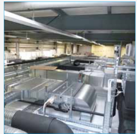
Klima- und Umlufteinheiten
