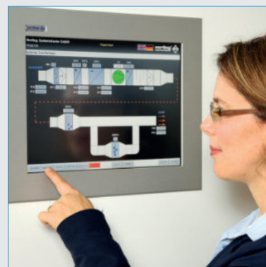
Die zentrale Raumsteuerung über Touchpanel
